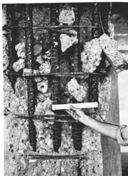
Figure 5 - No anchoring of the stirrups in the column core (A. Castellani, D. Benedetti, A. Castoldi, E. Faccioli, G. Grandori, R. Nova, "Costruzioni in zona sismia", Masson Italia Editore, Milan, 1981)
