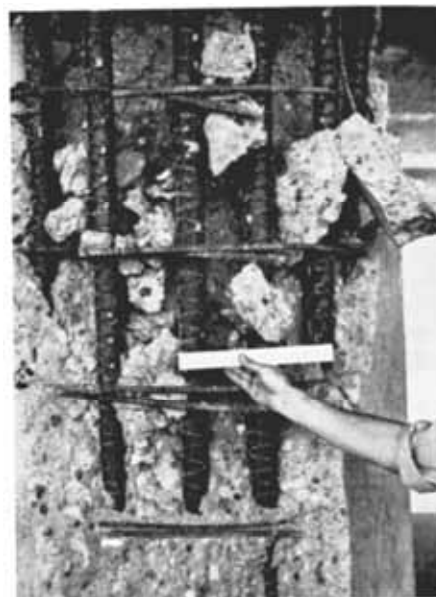
Figura 5 - Assenza di ancoraggio delle staffe nel nucleo della colonna (vedi A. Castellani, D. Benedetti, A. Castoldi, E. Faccioli, G. Grandori, R. Nova, "Costruzioni in zona sismica", Masson Italia Editore, Milano, 1981)
